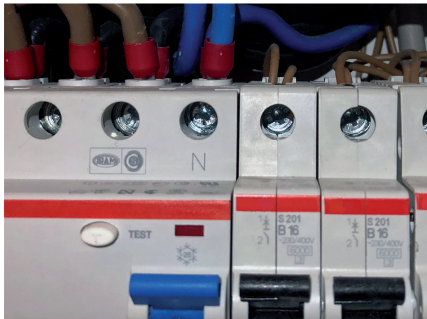
Abb. 3: Verdeckter (fingersicherer) Einbau von Anschlussklemmen
