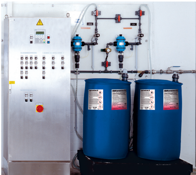
Abb. 4: Automatische Dosier- und Mischstation mit fester Verrohrung, Calvatis GmbH
