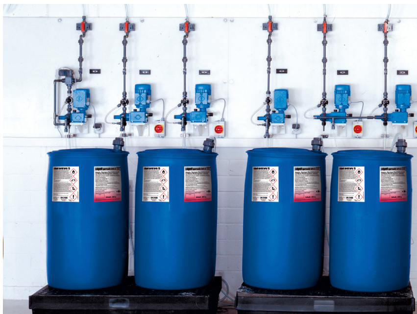
Abb. 2: Lagerung von Kunststoffgebinden auf geeigneten Auffangwannen, Calvatis GmbH
