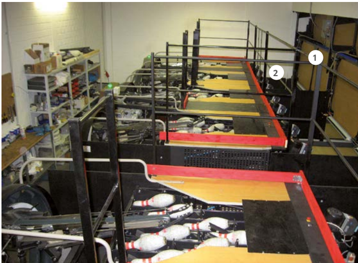
Abb. 32 Lauf- und Arbeitsbereich oberhalb der Stellmaschinen mit Absturz-sicherung (Handlauf und Knieleiste)
