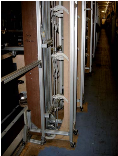
Abb. 22 Pinaufzüge mit ungesicherten Gefahrstellen
